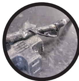
硬化・折れ曲がり
