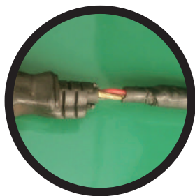
被膜の剥がれ
